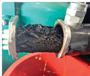
사례 1 : 냉각수방치로 인한 히터 및 라디에이터 손상교체
